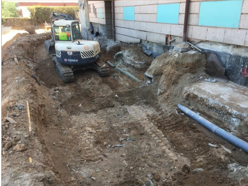
Foto 9. Vista dels treballs d'excavació al llarg de la façana est de l'edifici
